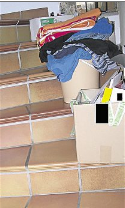
Auch voll gestellte Treppenaufgänge stellen eine erhebliche Gefahrenquelle dar. Hier wäre leicht für Abhilfe zu sorgen. Bild: hzf
